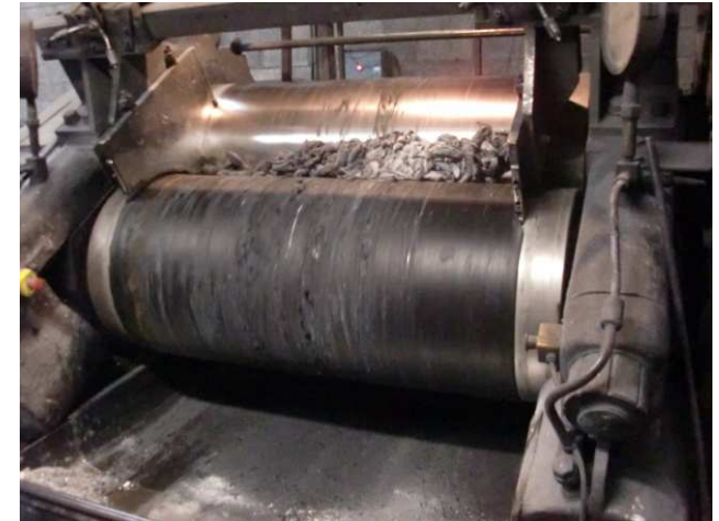
Mélangeur ouvert à cylindre pour réaliser l'élastomère
