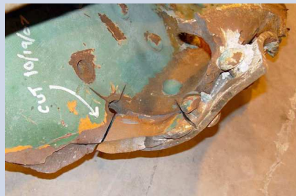
Fracture dans un gousset (NTSB 2008)
