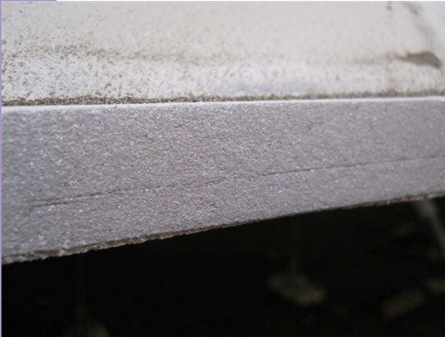
Fissure lors de la détection Photo LRPC de Nancy
