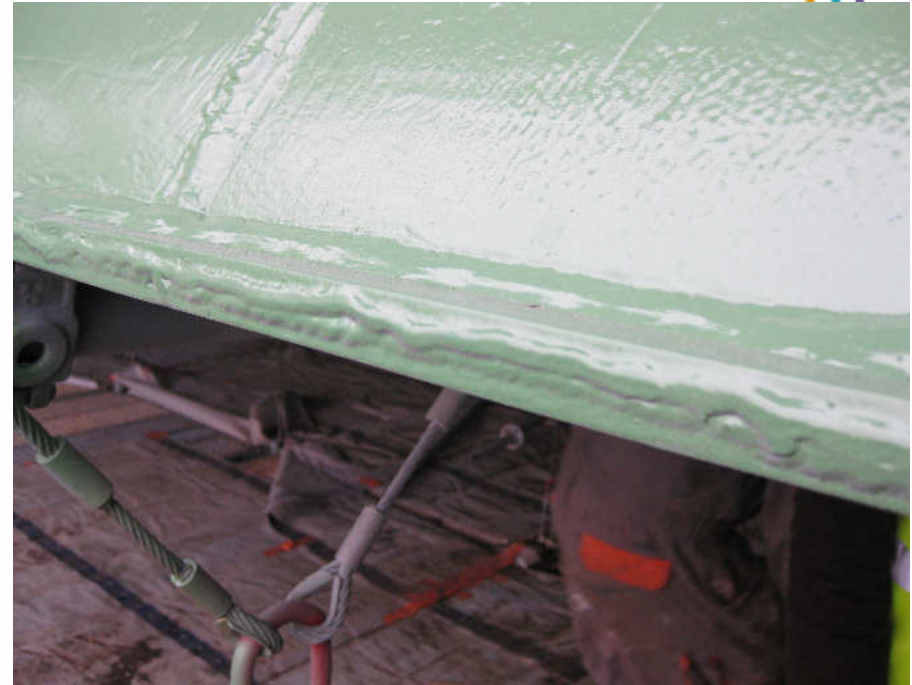
Fissure après son obturation
