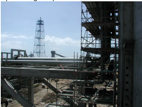
Pipe rack et gaines précontraintes
