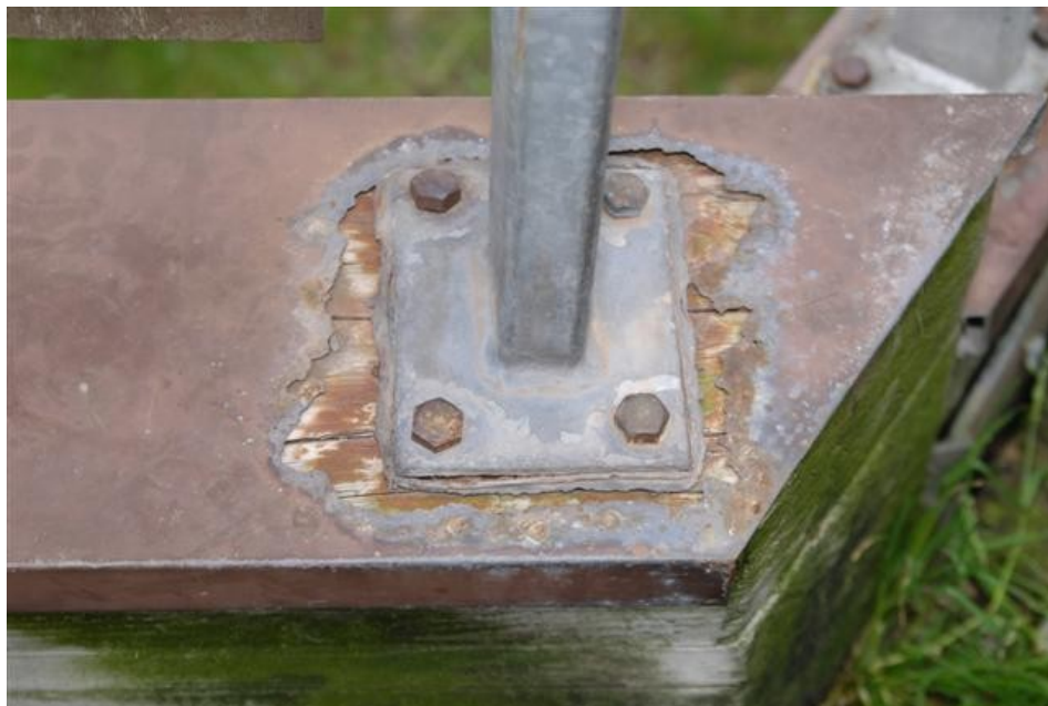
Corrosion de la tôle de couvertine en pied de garde corps : effet de pile ?
