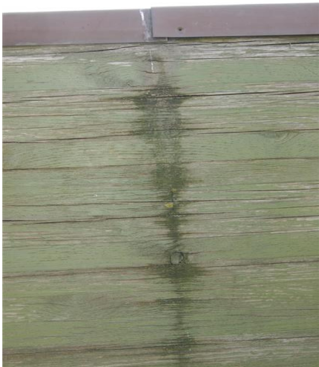
Discontinuité de la couverture : infiltration d'eau en partie supérieure
