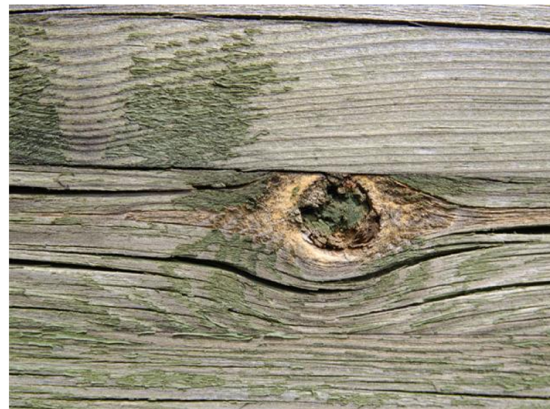
Absence de protection de la poutre BLC : apparition de fentes
