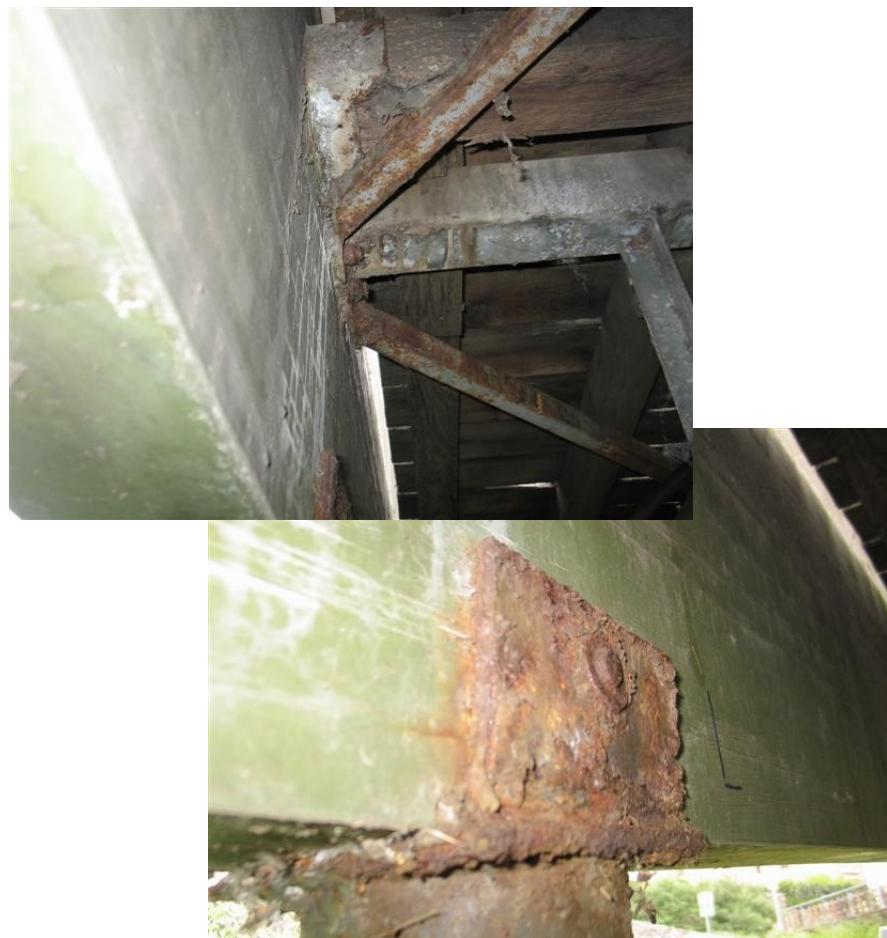
Corrosion des contreventements et des organes d'assemblage
