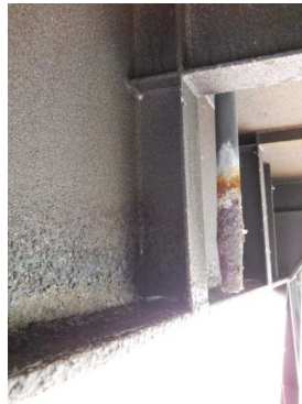
Mauvaise évacuation des eaux
