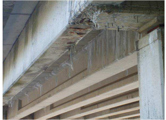
« Pourrissement » des bétons,
