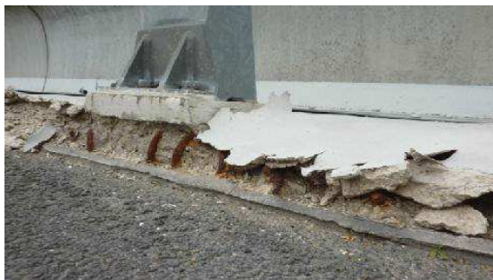
Dégradation des bétons de longrines support d'équipements
