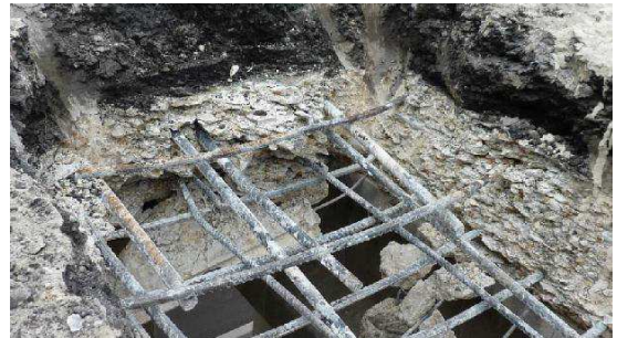
Etat du béton de dalle
