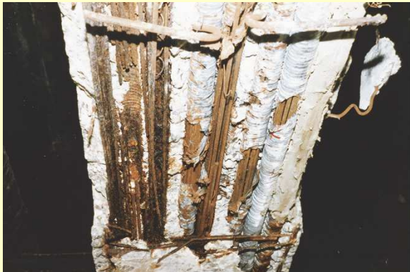
Câbles corrodés (VIPP)
