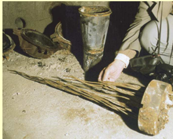
Rupture de câble en biseau derrière une tête d'ancrage
