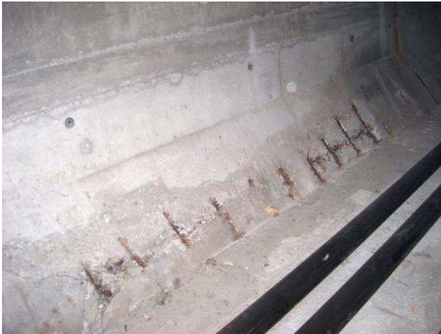
Intérieur d'un caisson en BP – Défauts d'enrobage – Photos CG54
