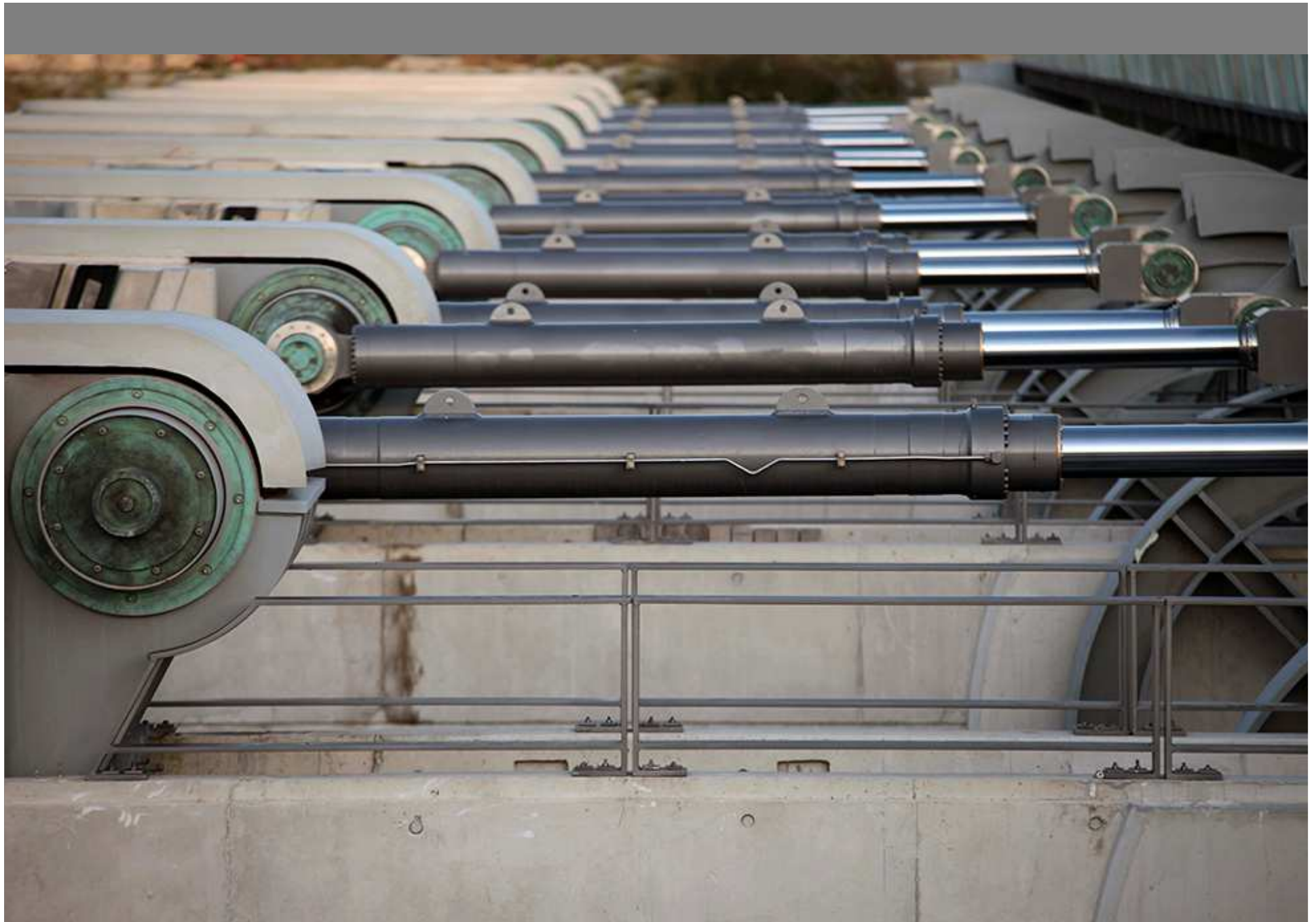
le barrage du Mont Saint-Michel
