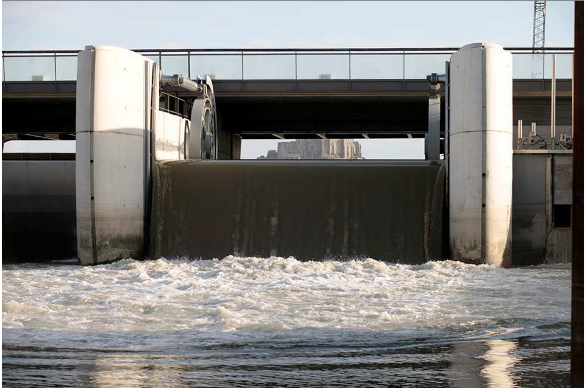
le barrage du Mont Saint-Michel
