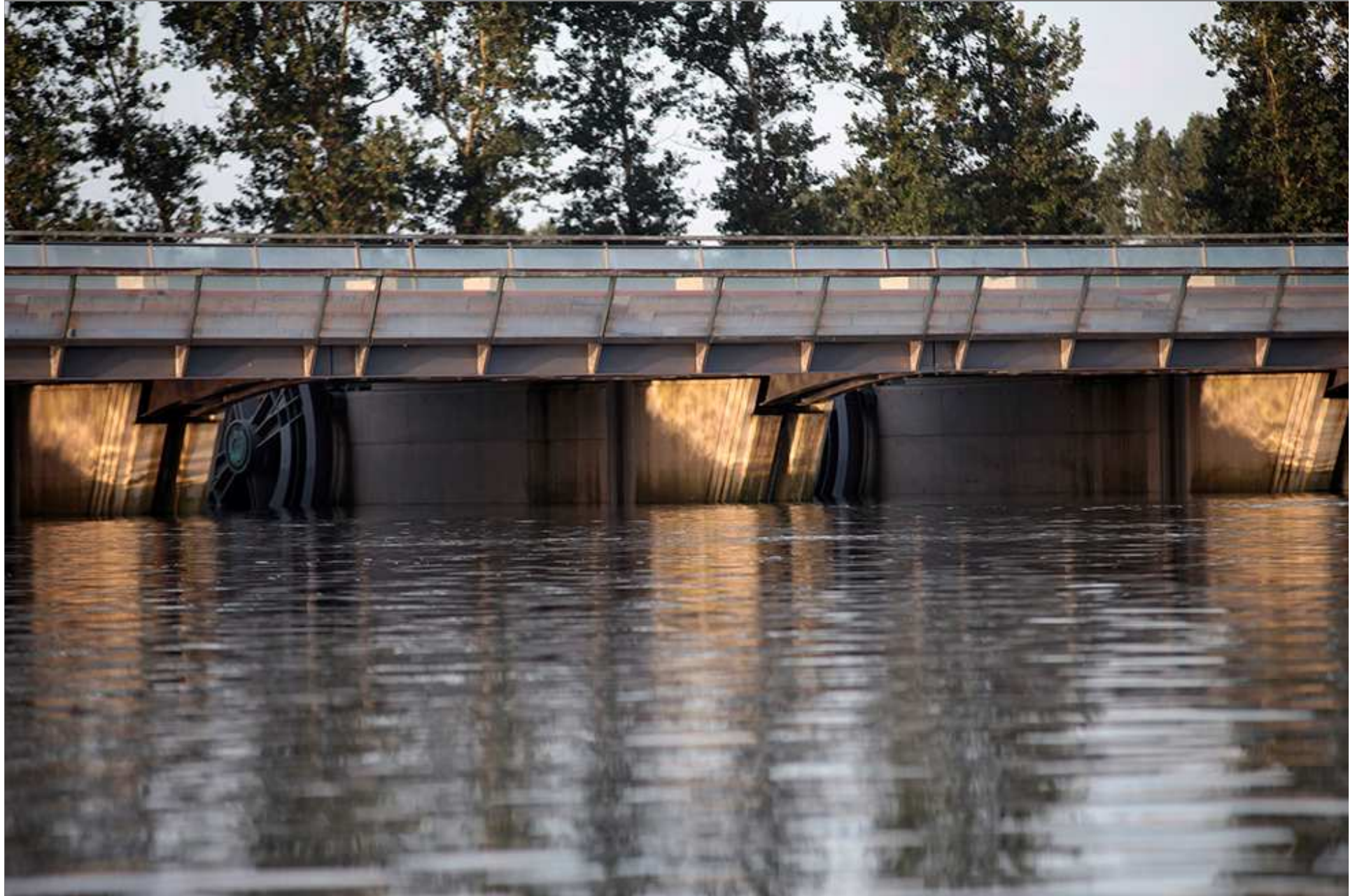
le barrage du Mont Saint-Michel
