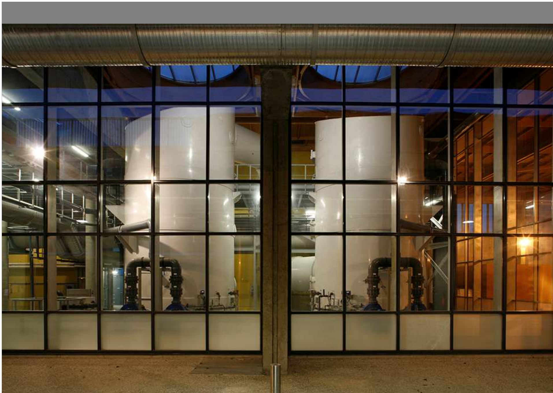
l'unité de traitement des pollutions azotées
