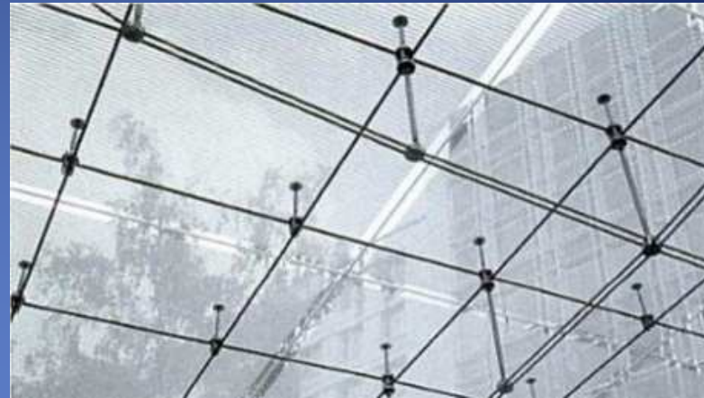
Structures à câbles
