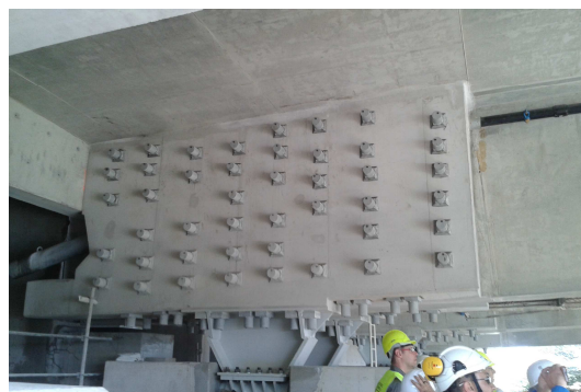
Vue générale d'un des bossages d'extrémité des tabliers d'accès servant à l'ancrage des câbles extérieur de renforcement et à l'ancrage sur le tablier du Ressort Antisismique Précontraint (RAP) permettant de bloquer avec une certaine souplesse le tablier à la culée.
