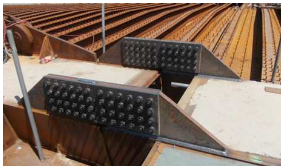
Figure 31 : Blocage provisoire entre travées
