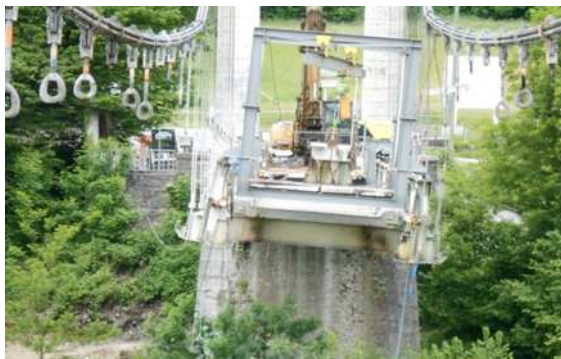
Rotation du tablier suite aux différences de tensions dans les câbles
