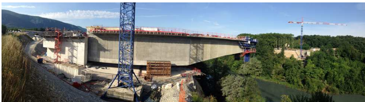
Fléau rive gauche au niveau du voussoir V7
