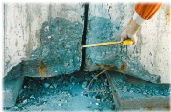
Eclatement des abouts de poutre sur la pile P7 constaté en 1980 : conséquence de la mise en compression du tablier
