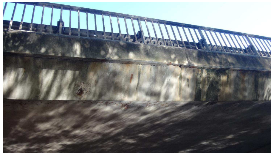
Corrosion des aciers avec éclatement de bétons situés sur les joues, en intrados des aux abouts des dalles
