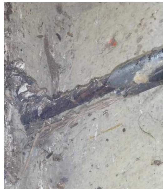
Conduit de protection de la précontrainte extérieure dégradé avec oxydation localisée des torons
