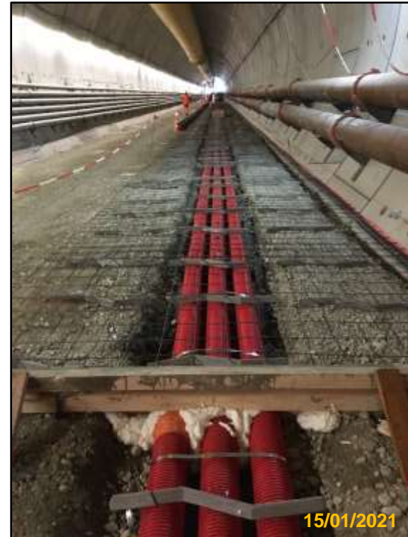
Mise en place des réseaux et ferrailage radier en demi voie (Ouest)
