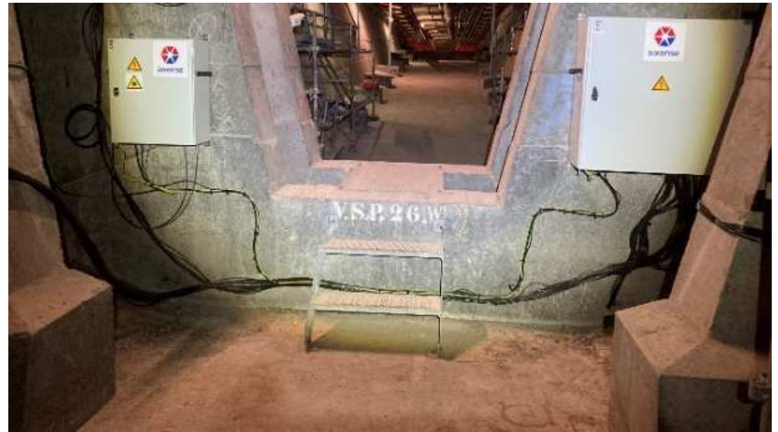
Armoires de jonction
